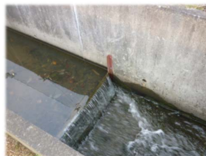
設置された堰上げ板
