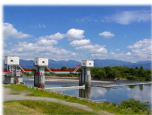
最上川から取水する 三郷堰頭首工 (出典：国土強靱化民間取組事例集)
