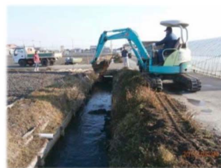
排水路の泥上げ （出典：農林水産省HP 多面的機能支払交付金の取組事例）
