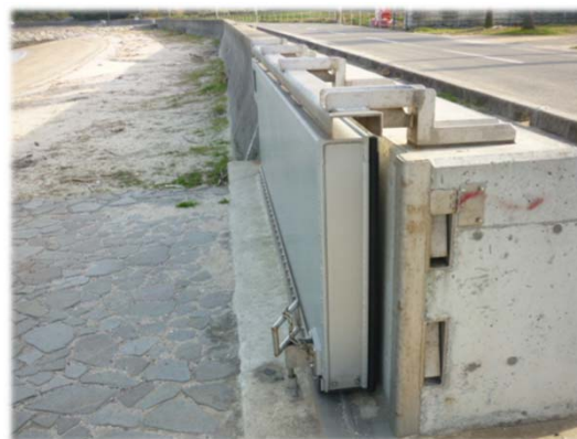
設置されたスライド式ゲート
