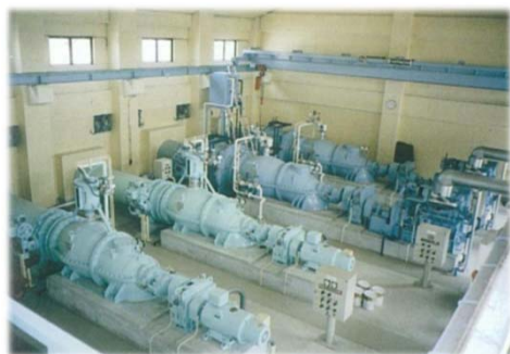
排水機場のポンプ設備 (農林水産省HP)
