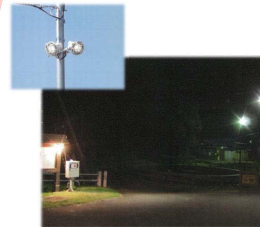
夜間の点灯状況 (出典：秋田県仙北平野土地改良区提供資料)
