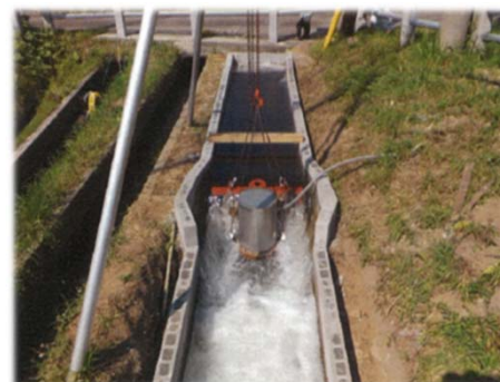
ダリウス水車による水力発電 (出典：秋田県仙北平野土地改良区提供資料)
