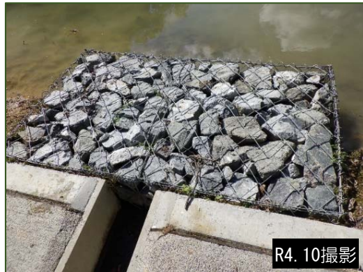
③土砂流出防止のために設置されたふとんかご
