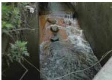
改良された魚道（片斜式粗石付魚道）
