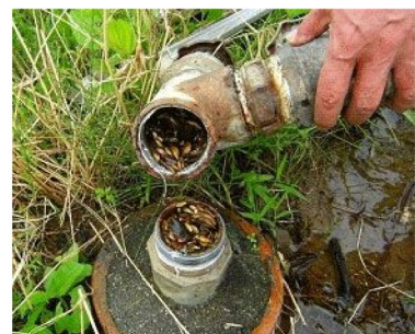
給水栓の目詰まり
