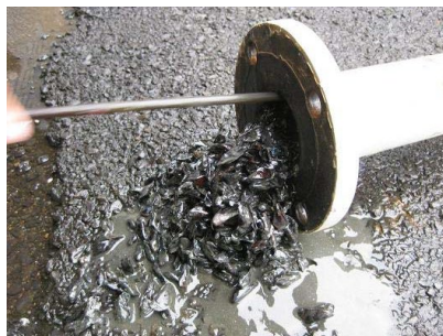
配管の目詰まり
