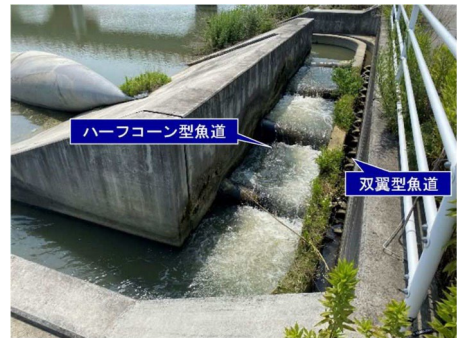
堰樋堰に設置された魚道
