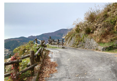
▲脱輪防止用ブロックと間伐材防護柵
