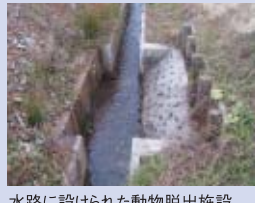
水路に設けられた動物脱出施設 (写真提供:東北農政局いさわ南部農地整備事業所)
