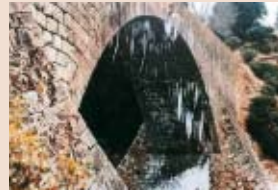
補修前の水漏状況 (写真提供:熊本県上益城地域振興局農地整備課)
