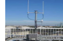
通信施設の整備
