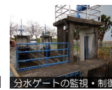
分水ゲートの監視・制御
