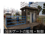
分水ゲートの監視・制御
