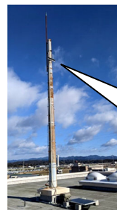
LPWA 基地局 (袋井市役所屋上)
