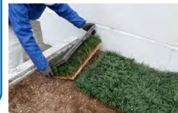
マットタイプを利用した造園施工の様子 トレーから外すだけで「緑のじゅうたん」が完成する。造園工費コスト削減だけでなく、障害の有無に関係なく作業ができるメリットもある。
