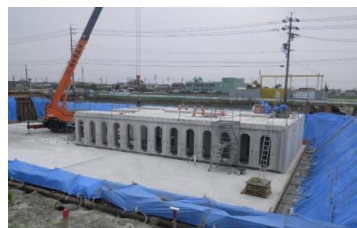
雨水貯留施設の整備 （北名古屋市）
