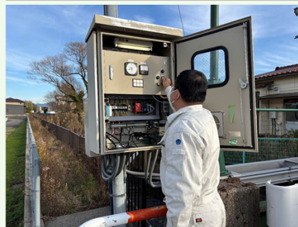
施設管理者による水門・堰の操作状況
