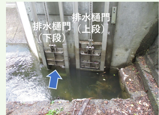
排水樋門(下段)からの排水状況
