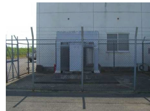
（盗難対策） フェンス、車止め等
