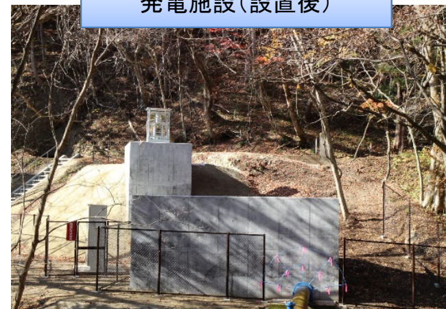
発電施設(設置後)
