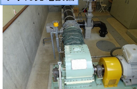
小水力発電設備
