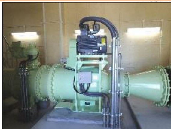
平津小水力発電所
