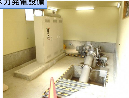
小水力発電設備
