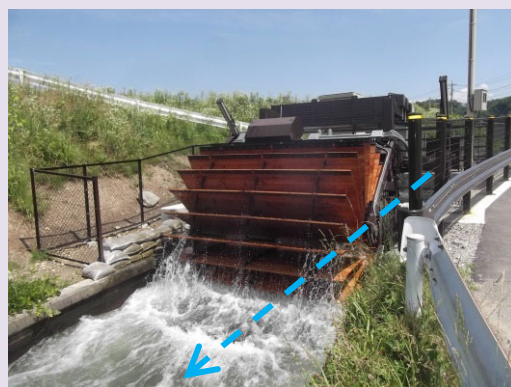
小水力発電施設 (1号機)
