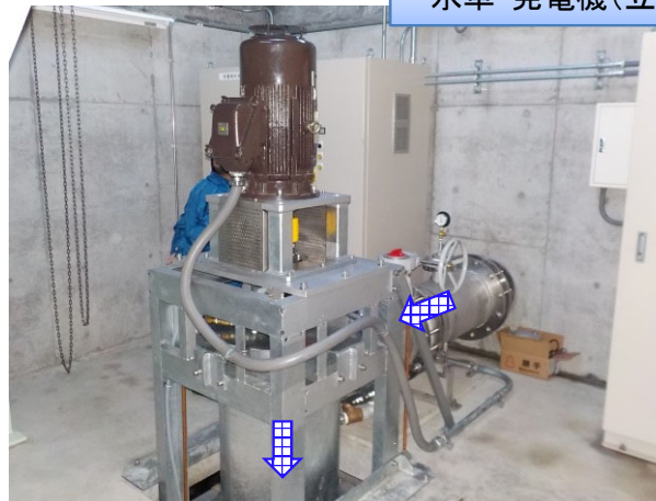
水車・発電機(立軸スクルー水車)
