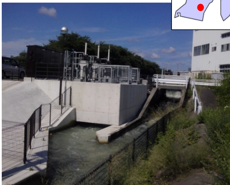
細島発電所全景
