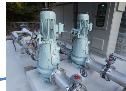
小水力発電施設
