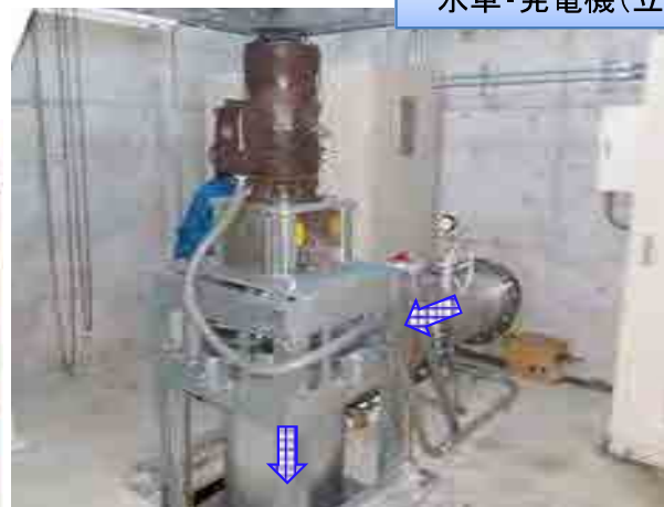
水車・発電機(立軸スクルー水車)
