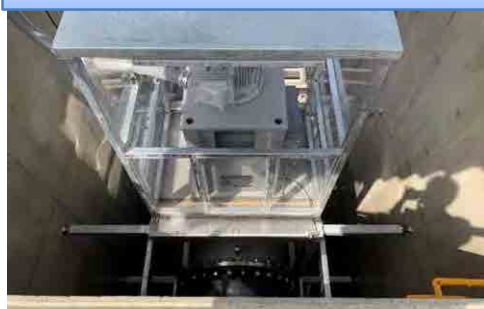
水車発電機(縦軸軸流水車)
