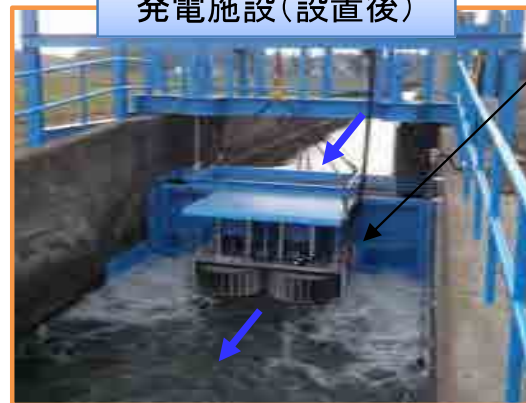
発電施設(設置後)
