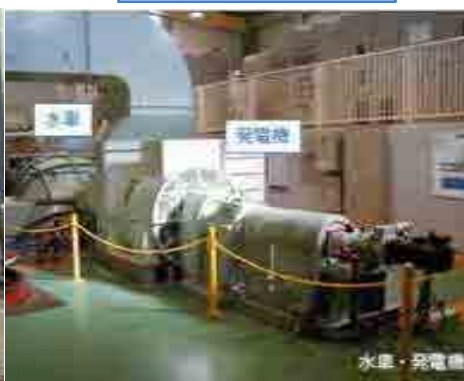
小水力発電設備
