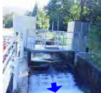
水車発電機(1号落差工)
