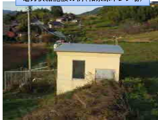
電力供給施設の例(和泉原ポンプ場)
