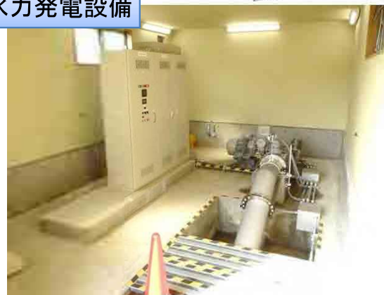
小水力発電設備
