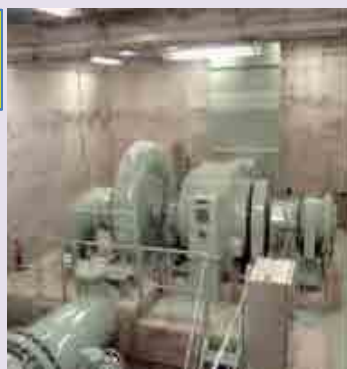
小水力発電施設
