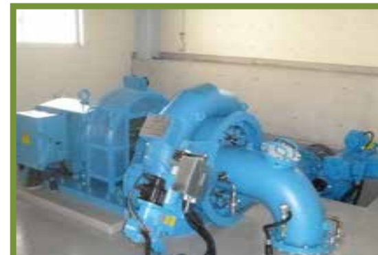
水車・発電機
