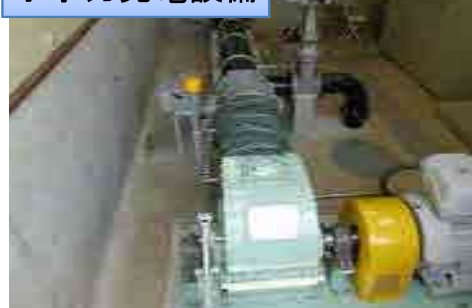
小水力発電設備
