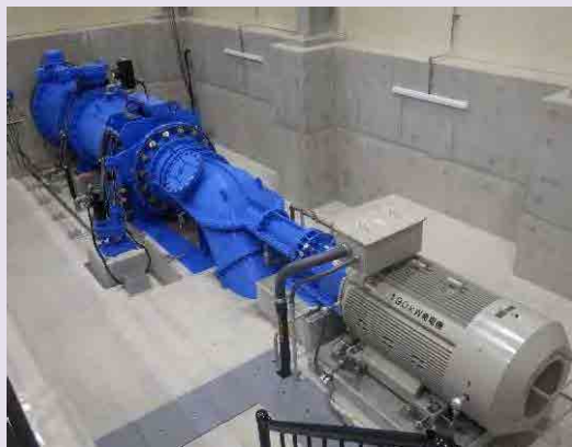
水車発電機 (S形チューブラ)
