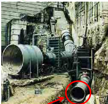
発電所への管路(Φ1200mm)
