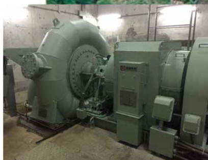
小水力発電設備 （横軸単輪単流渦巻 形フランシス水車）
