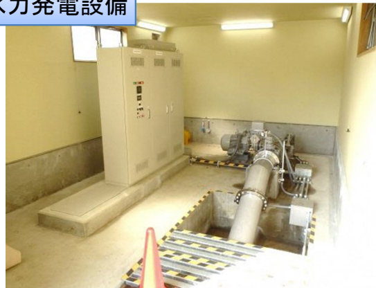
小水力発電設備
