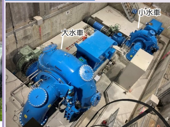
小水力発電設備
