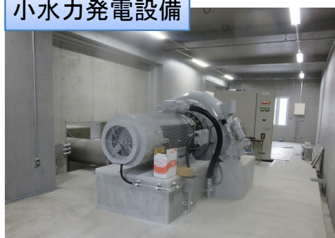
小水力発電設備
