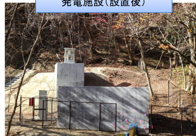
発電施設（設置後）
