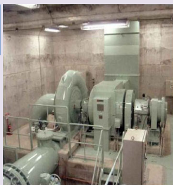
小水力発電施設
