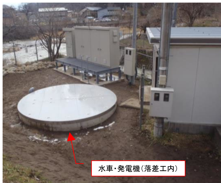
発電施設全景
