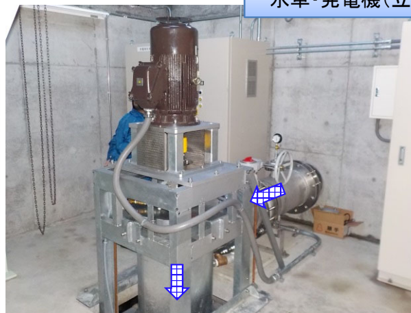
水車・発電機(立軸スクルー水車)
