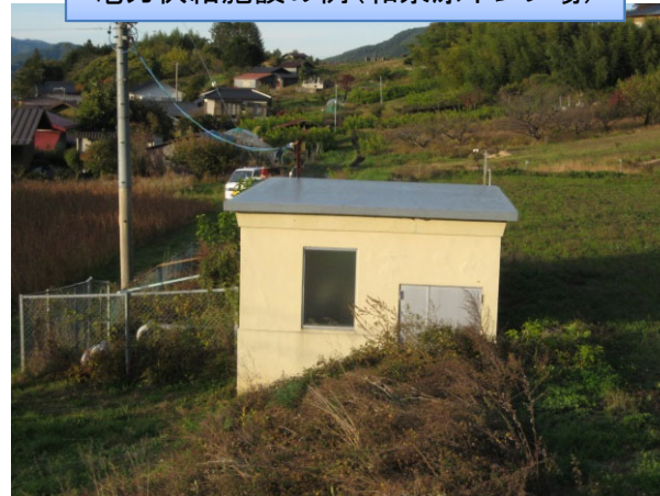
電力供給施設の例(和泉原ポンプ場)
