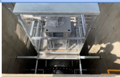
水車発電機(縦軸軸流水車)
