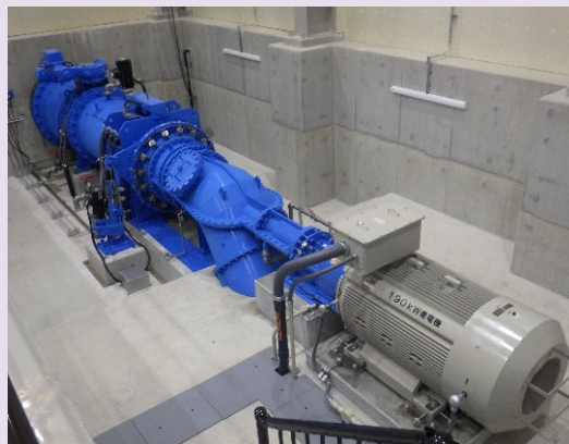
水車発電機 (S形チューブラ)
