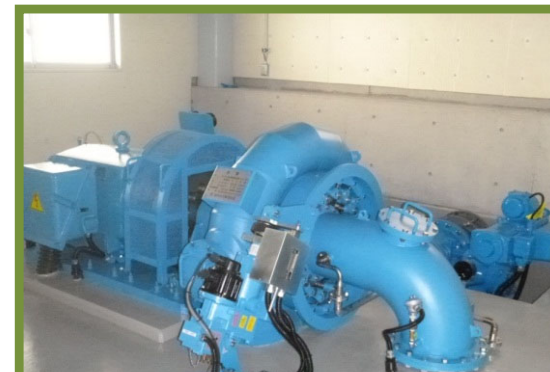
水車・発電機
