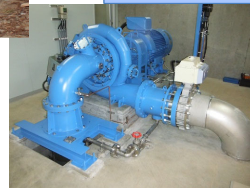
水車・発電機
