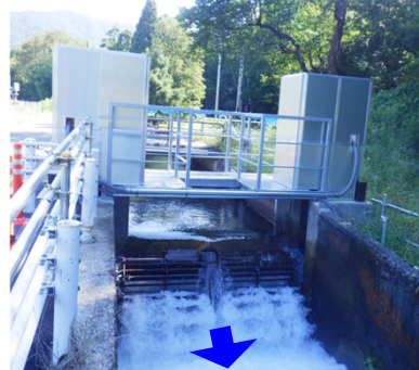
水車発電機(1号落差工)
