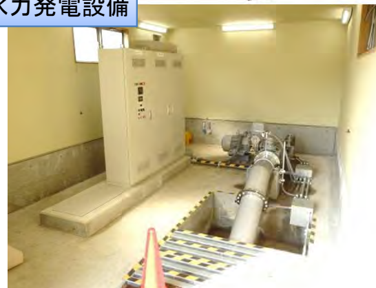
小水力発電設備
