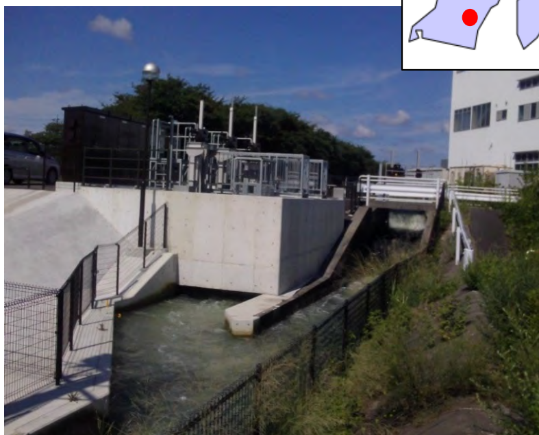
細島発電所全景
