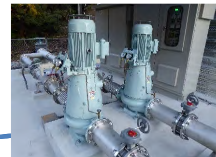
小水力発電施設
