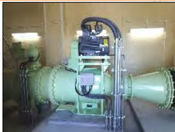
平津小水力発電所
