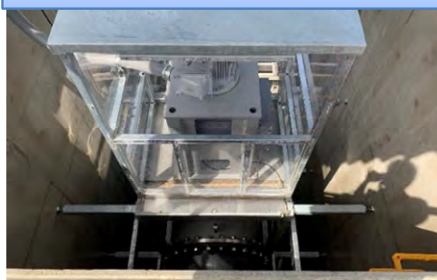
水車発電機(縦軸軸流水車)
