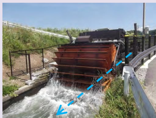
小水力発電施設 (1号機)
