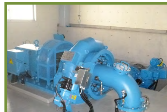
水車・発電機
