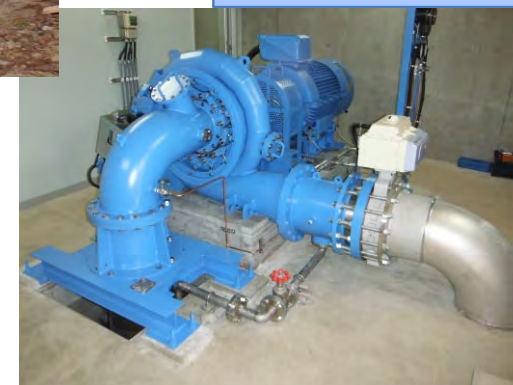
水車・発電機
