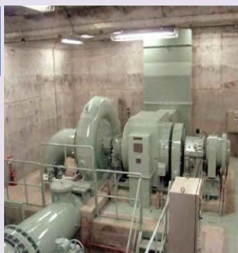
小水力発電施設
