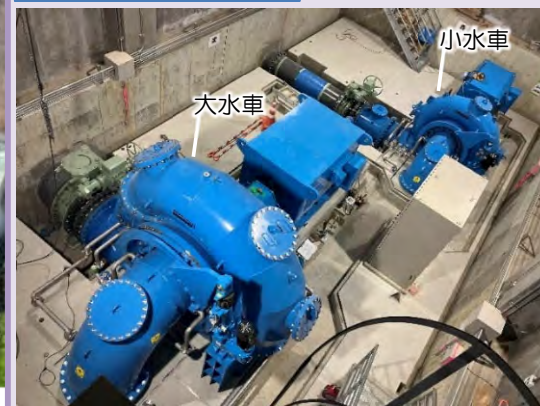
小水力発電設備
