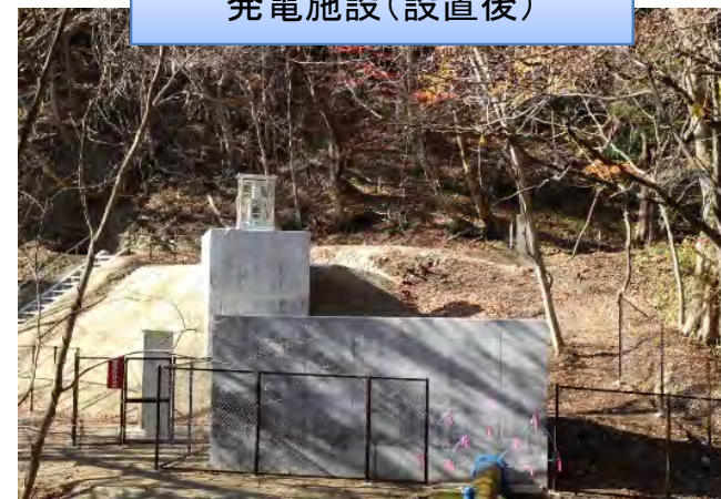
発電施設(設置後)
