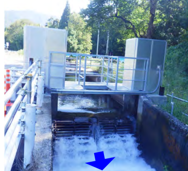
水車発電機(1号落差工)
