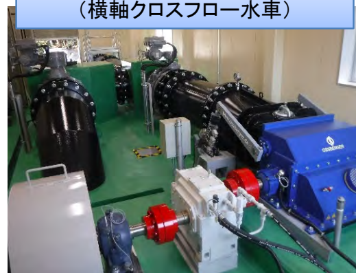
水車発電機 (横軸クロスフロー水車)
