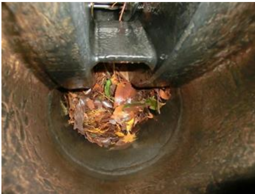
図 4-3 水車内の塵芥（落ち葉）（写真提供：東京発電株式会社）
