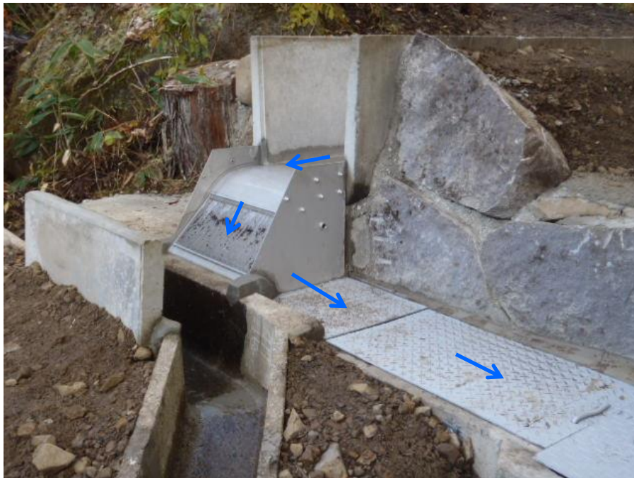
図 4-23 スクリーンの設置例(写真提供：日本エンヂニヤ株式会社)
