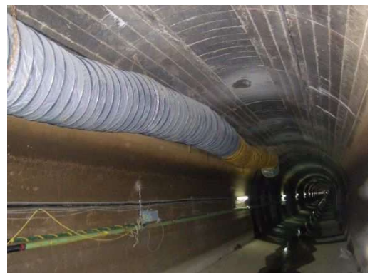
写真-4.6.2-2 換気設備（坑内設備）
