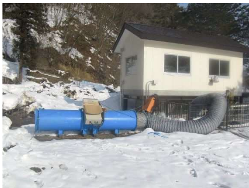
写真-4.6.2-1 換気設備（坑外設備）
