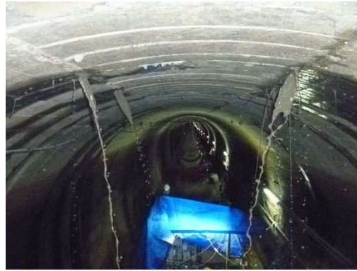
写真-5.2.2-1 裏込注入材（非可塑性注入材）の漏出
