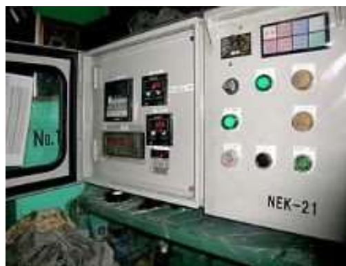
写真-5.4.7-8 注入機操作盤
