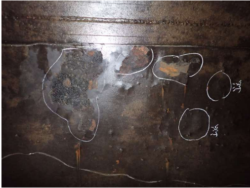
写真-6.7.1-3 面的な塗膜浮き・剥離
