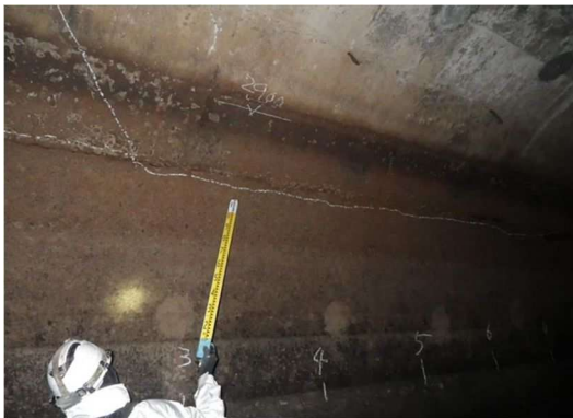
写真-10.2.2-1 S.L.付近の縦断方向ひび割れ
