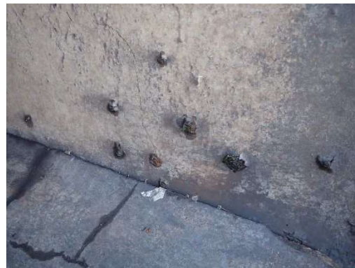
写真-12.1.2 鋼板内張工法の腐食状況
