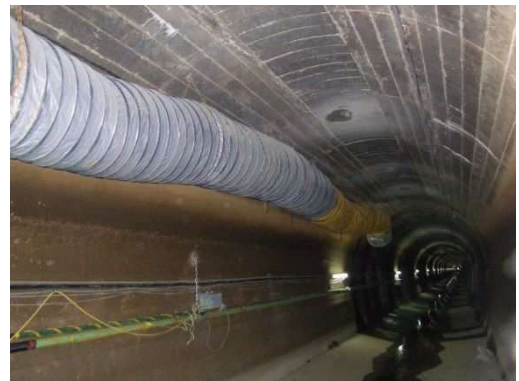
写真-4.6.2-2 換気設備（坑内設備）
