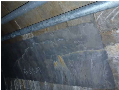
写真-12.1.1 補修工法施工後の再劣化
