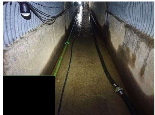
写真-11.5.4-30 可塑性注入材注入用配管
