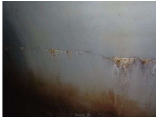
写真-9.2.2-1 繊維系接着工法のひび割れ（析出物有り）
