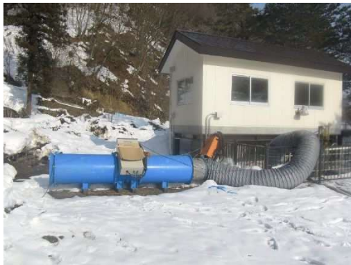
写真-4.6.2-1 換気設備（坑外設備）
