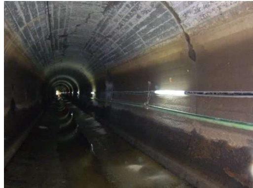
写真-4.6.2-4 照明設備（通路）
