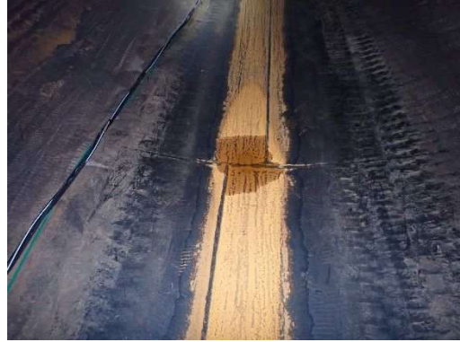
写真-6.7.1-4 インバート材の摩耗腐食
