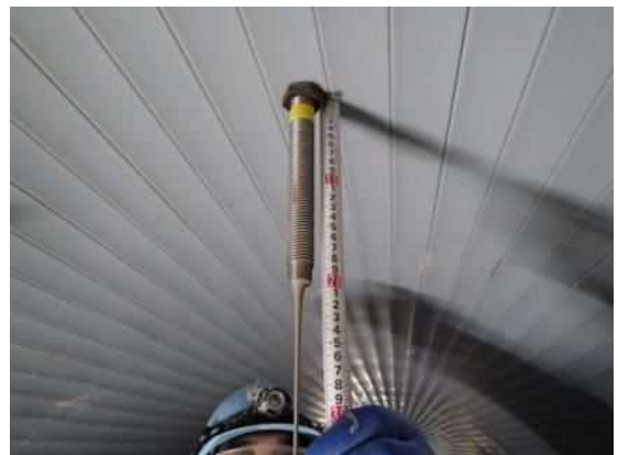
写真-8.5.7-8 空気抜き状況
