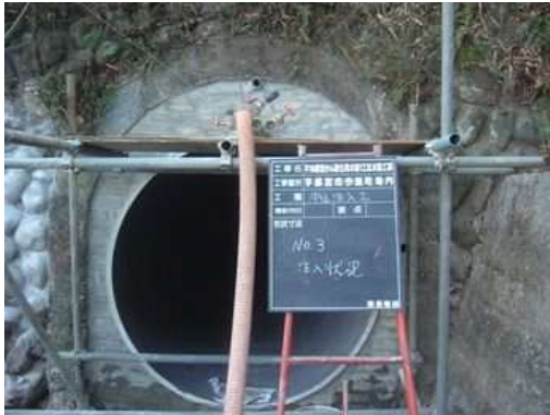
写真-7.5.7-4 空気抜き管（管頂位置）
