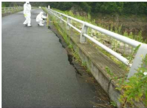
③上流地覆コンクリート付近での開口穴・段差
