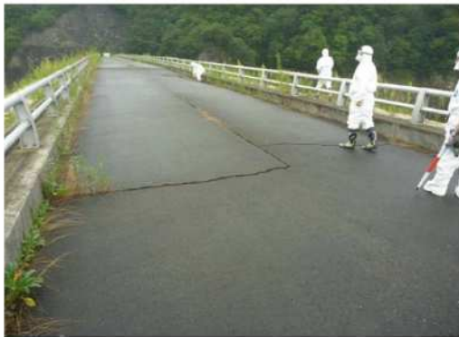
①堤体大端アスファルト舗装面における開口亀裂等
