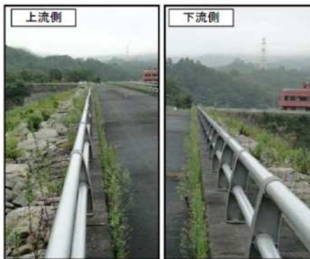
⑤アルミ高欄・地覆の釜み
