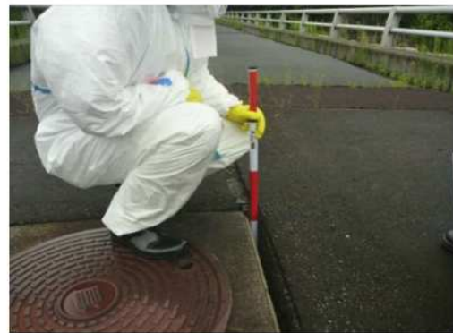
④マンホール周辺での開口
