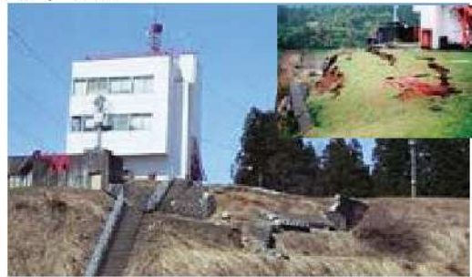
管理棟被災状況
