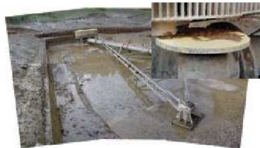
取水施設被災状況
