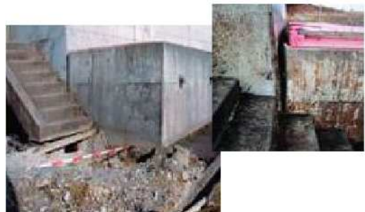
調圧水槽被災状況
