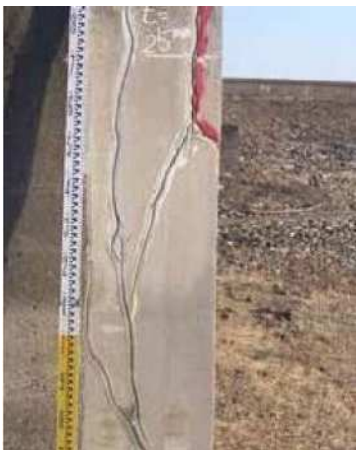
写真-5.1-9 洪水吐(導流壁)のクラック (西郷ダム)
