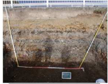
②クラック追跡調査 ・テストピットを天端から3.3mばで掘削し、仕上げた。
