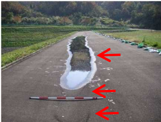
写真-5.1-4 天端の沈下 （山本第二調整池※参考）
