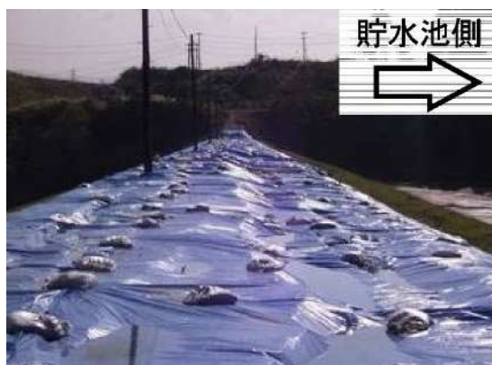
写真-5.3-3 天端クラックのブルーシートによる保護（浅河原調整池）
