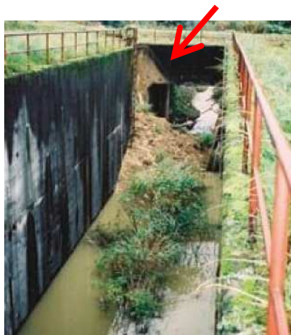
写真-5.1-10 洪水吐側壁の倒壊 (川西ダム)
