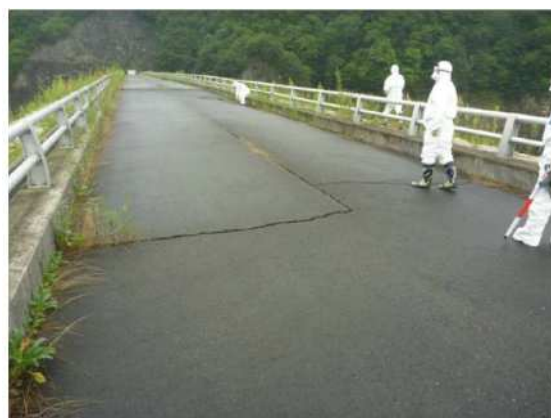
写真-5.1-2 天端舗装面のクラック （大柿ダム）
