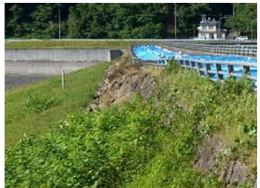
写真-5.1-11 波返工(パラペット)石積工の上流への崩落及び高欄の傾倒 (衣川1号ダム)
