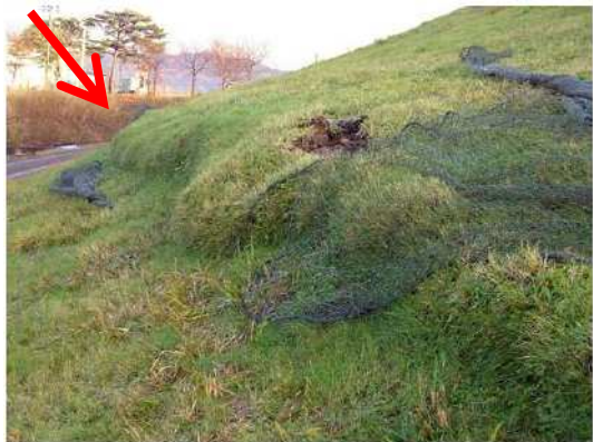
写真-5.1-8 下流法面のはらみ出し (山本第二調整池※参考) : 右図写真-10
