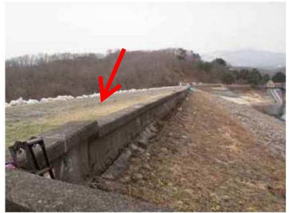
写真-5.1-5 波返工（パラペット）の 目地の開き・段差（西郷ダム）
