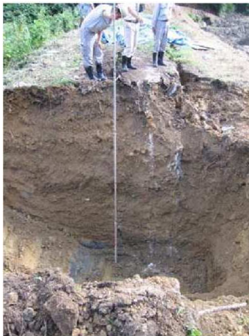
写真-5.2-6 亀裂確認状況（堤体開削）
