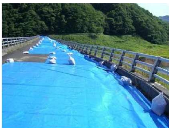
写真-5.3-1 天端クラックのブルーシートによる保護（衣川1号ダム）
