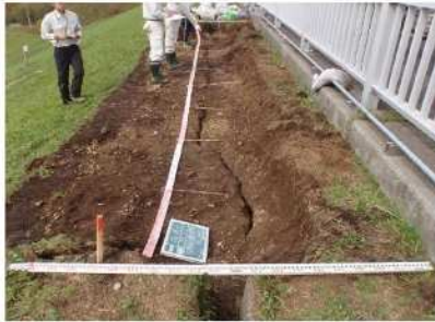
④40cm掘削面の観察 (写真撮影、スケッチ、クラック幅などの観察) ※リボンロッドは、高欄基礎コンクリートから1.5mの位置に設置
