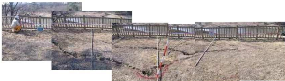
⑧右岸緑地帯部のクラック
