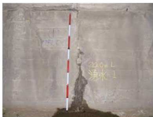
⑥洪水吐トンネル部のクラック
