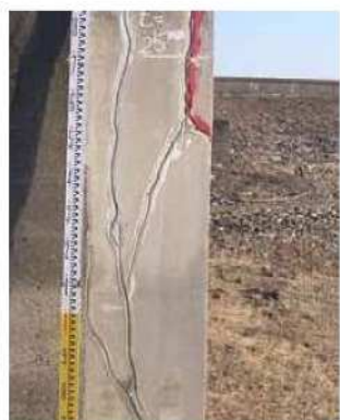
④洪水吐導流壁部のクラック
