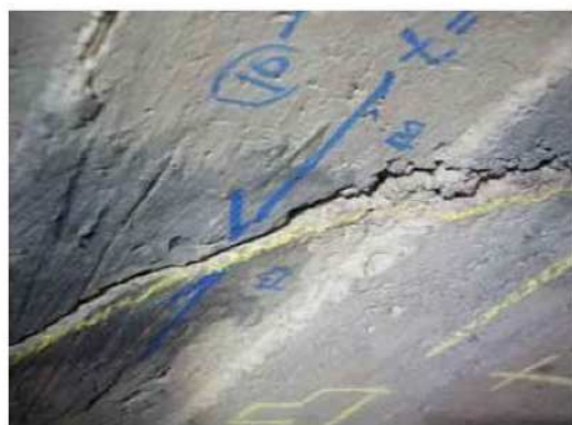
⑥取水トンネル部のクラック
