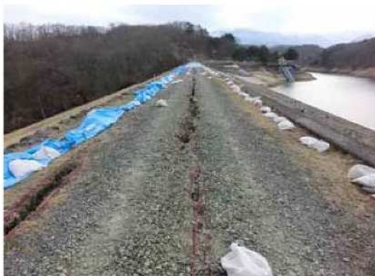
①大端のクラック
