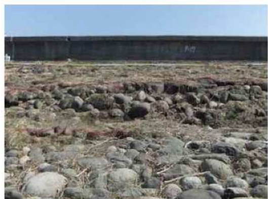
③上流法面の段差・不陸
