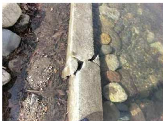
③法止コンクリートのクラック・変形
