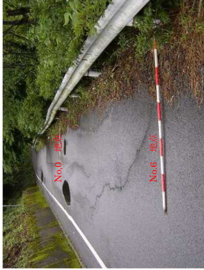
●貯水池周辺管理用道路法面の亀裂確認状況(T'ダム)
