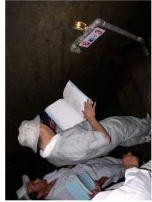
ブルドン管式圧力計の確認
