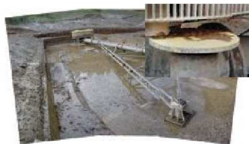
取水施設被災状況
