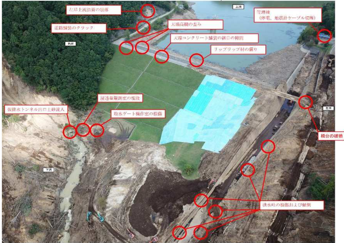
図-5.3-1 ダム被災状況写真 (厚真ダム (北海道))
