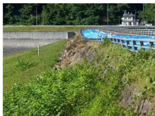
写真-5.1-11 波返工(パラペット)石積工の上流への崩落及び高欄の傾倒 (衣川1号ダム)
