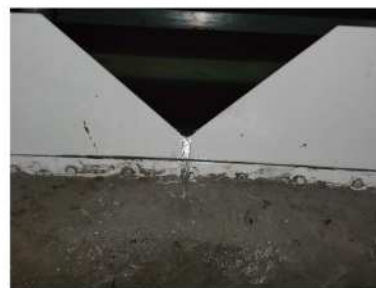
⑥ 浸透水越流状況
