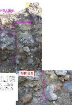
・【亀裂3】は、下流斜面から直. 8. 3mまで貫入しているが、二次側方面には到達していない。
