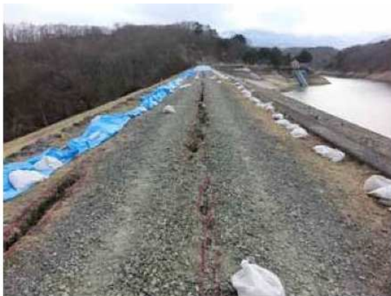
写真-5.1-1 天端のクラック（ダム軸方向） （西郷ダム）
