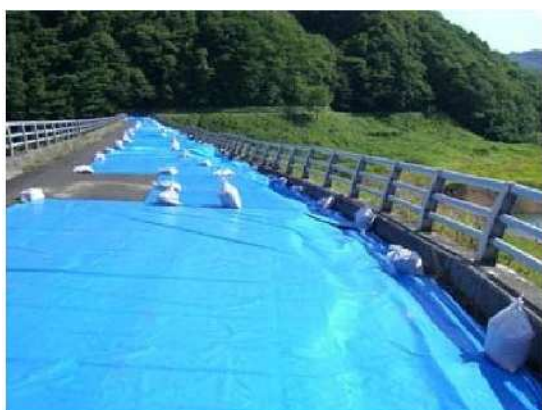
写真-5.3-1 天端クラックのブルーシートによる保護（衣川1号ダム）
