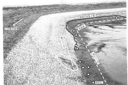
写真-12 堆泥によるドレーン前面閉塞状況(新山本調整池)
