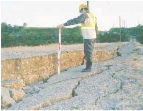
写真-5.1-3 天端の段差・沈下（浅河原調整池※参考） ：右図写真-1
