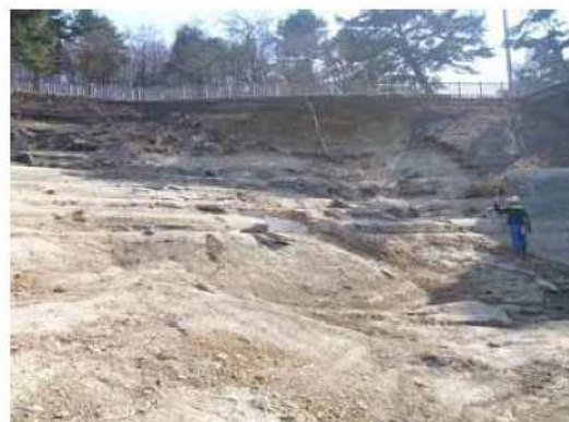
⑦右岸法面保護工部の崩落
