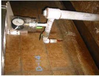
ブルドン管式圧力計：排水孔内を鉄バケテリア、遊離石灰が占有している
