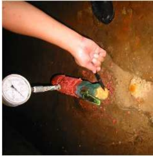
ブルドン管式圧力計：排水孔内を鉄バケテリア、遊離石灰が占有している
