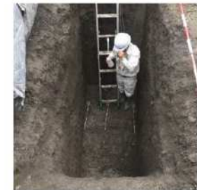
⑧ 亀裂分布確認
