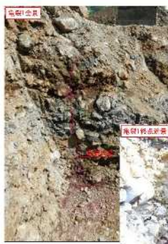
・【亀裂1】は、4号清田土から、フィルターゾーン上面の直. 8. 4mまで貫通しているため、フィルターゾーンへの影響は大きいと判断される。
