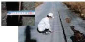
管理道路被災状況
