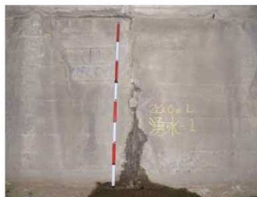
⑥洪水吐トンネル部のクラック
