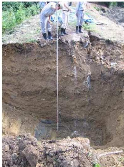
写真-5.2-6 亀裂確認状況（堤体開削）
