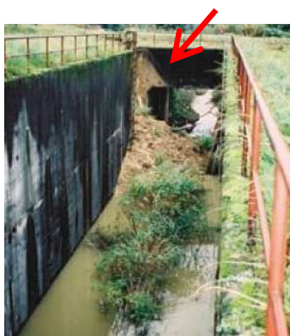
写真-5.1-10 洪水吐側壁の倒壊 (川西ダム)
