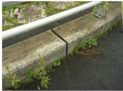
②上下流地覆コンクリートの継目の閉き、 地覆へアスファルトの閉き
