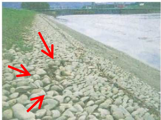
写真-5.1-6 堤体上流法面の段差・ずれ （山本調整池※参考）：右図写真-5
