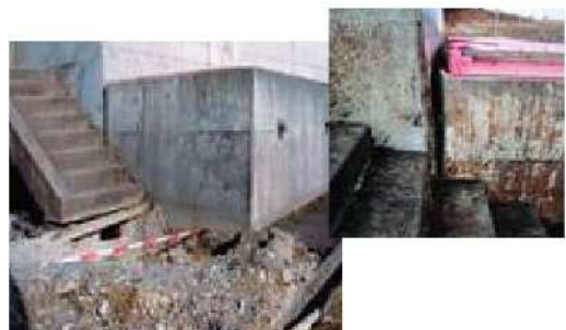
調圧水槽被災状況
