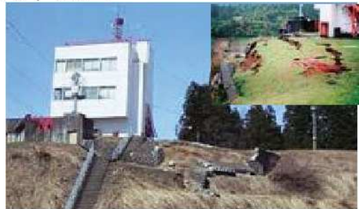
管理棟被災状況
