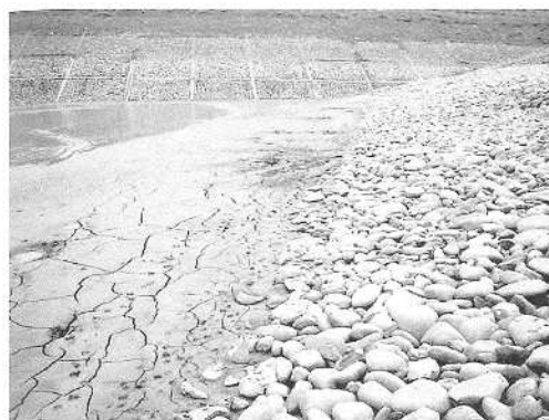
写真-9 左岸方噴砂状況(新山本調整池)
