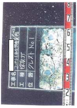
●コンクリートコアの採取例(Mダム) アルカリ骨材反応がみられる洪水吐コン
