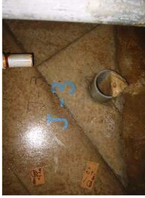
継目排水孔:内を鉄バケテリア、遊離石灰が
