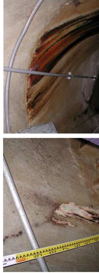
継目からの漏水(アーチ部)
