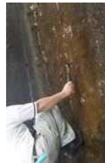
●ハンマー打撃による水路底板の変形確認状況(ダム)
