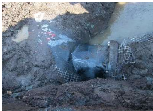
パイプラインの破損
