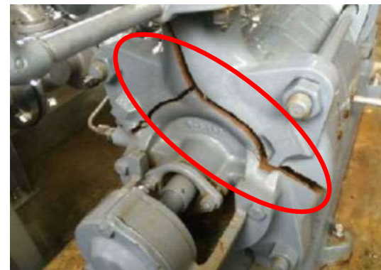
揚水機のモーター破損
