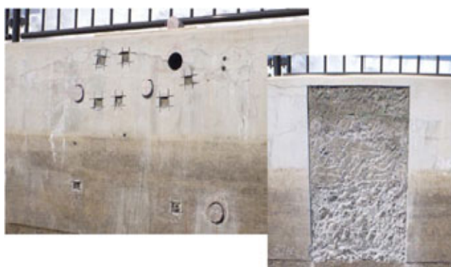
図 11.5.2-4 【はつり調査状況】
