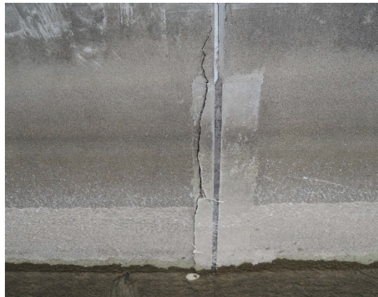
写真 5.1.4.3-1 目地に起因したひび割れの事例
